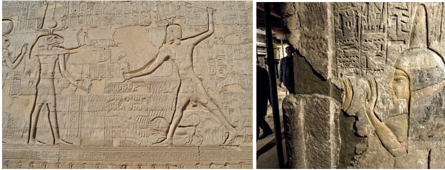
Рис. 71-72 Следы отшелушенного раствора и штукатурки на стенах. Фото из свободного доступа Интернета.
